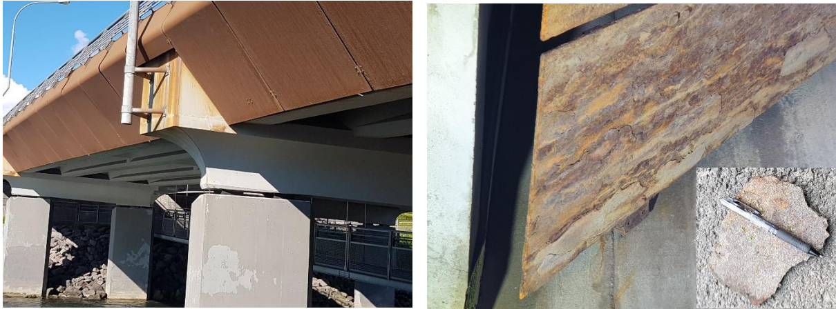
MYND 10 Gullinbrú. Brúin er yfir sjó. Hægra megin er mynd sem sýnir ryðflögnur á innra borð skjaldanna. Innfellda myndin sýnir flögu sem fallið hefur niður á göngustíg.
